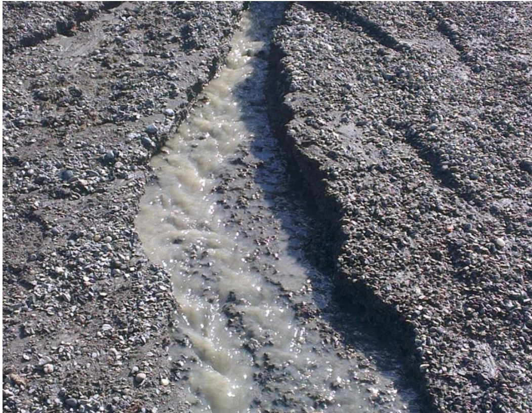
Figur 1. Overvann på avveie – skaper flomskader i veien.
