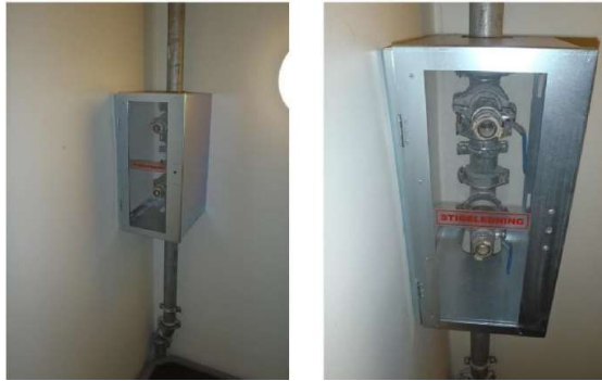
Figur 11: Godt eksempel på skap for beskyttelse av stigeledning/ tørropplegg mot hærverk
