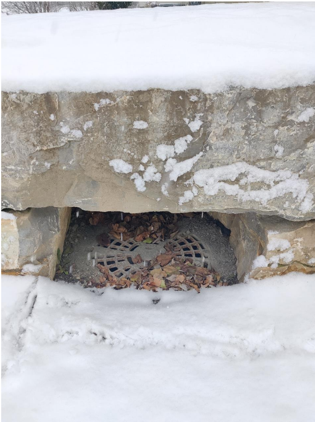
Figur 17 Sluk innunder kantstein. Ikke plassert i tydelig lavpunkt. Bildet er tatt mot nordvest og er knyttet til interessepunkt 1.
